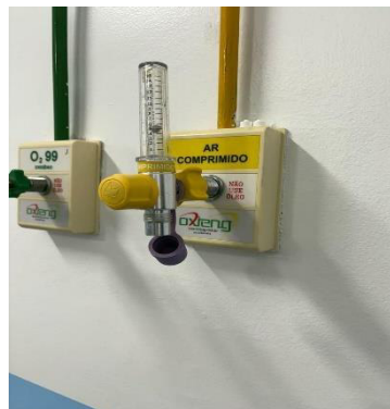
Figura 61 Instalação de fluxômetro de ar comprimido no setor.
