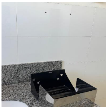
Figura 75 Instalação de suporte de papel no setor.
