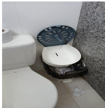
Figura 92 Instalação de suporte de papel higiênico no setor.
