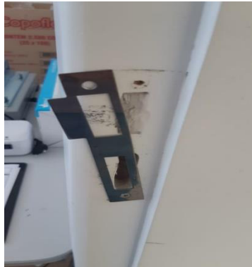
Figura 173 Corretiva na fechadura da porta do almoxarifado.
