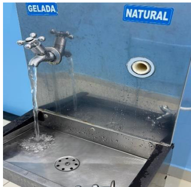
Figura 145 troca da torneira do bebedouro do setor.
