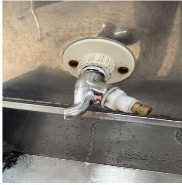
Figura 147 troca da torneira do bebedouro do setor.
