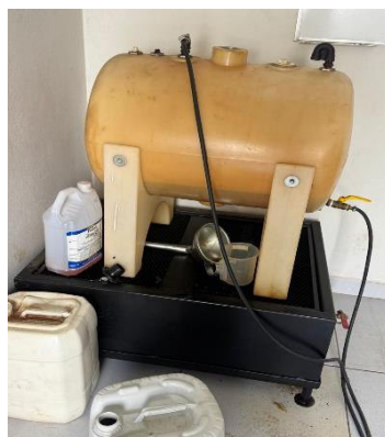
Figura 51 Reabastecimento do tanque de combustível do gerador.
