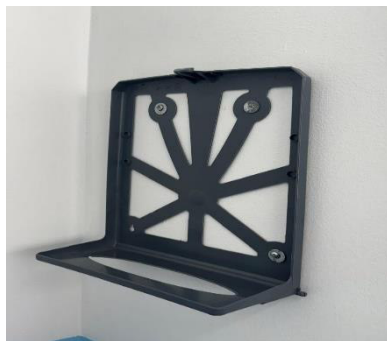
Figura 105 Instalação de suporte de papel no setor.
