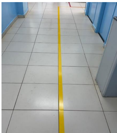
Figura 141 Instalação da faixa amarela nos corredores.
