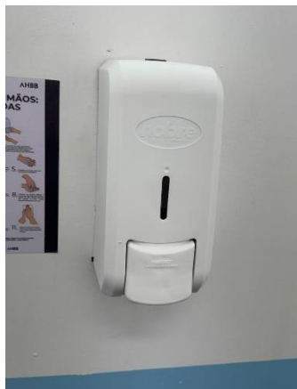
Figura 55 Instalação de dispenser de sabonete no setor.
