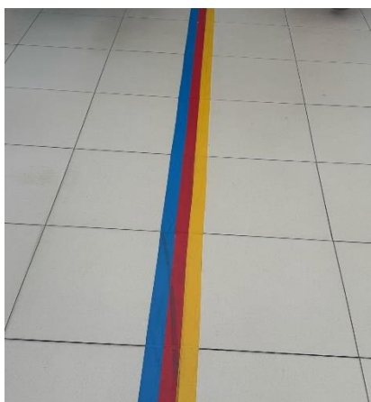
Figura 143 Instalação da faixa azul nos corredores.
