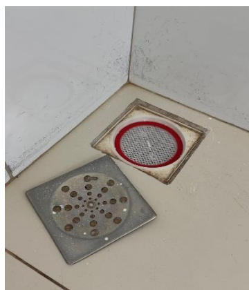
Figura 62 Reposição de filtro do ralo no setor.
