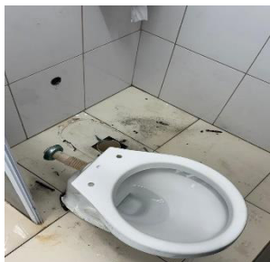
Figura 30 Corretiva no vaso sanitário do setor.
