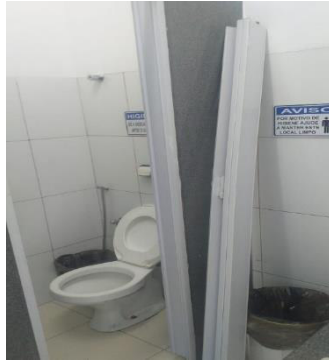
Figura 25 Corretiva na porta do banheiro feminino dos funcionários.
